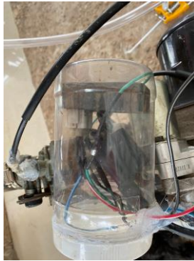
Hình 5. Hệ thống điện chống nước
